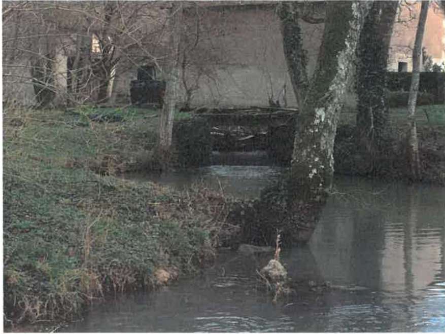
Photo 3 : Pertuis des anciennes vannes encombré. Les vannes ne sont plus présentes.
